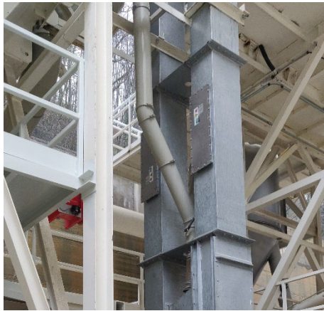
Fig. 5. Paneles de venteo en elevador
